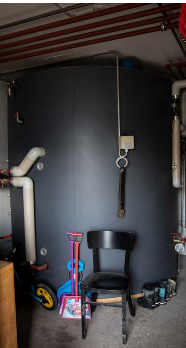
Im bestehenden 4700-Liter-Speicher wird der Stromüberschuss verheizt.
