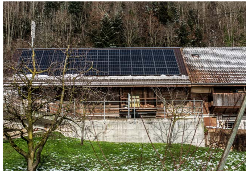
Ein Teil der 31 kWp-Photovoltaik-Anlage ist auf dem Stallgebäude platziert und der andere Teil auf einem weiteren Betriebsgebäude.
